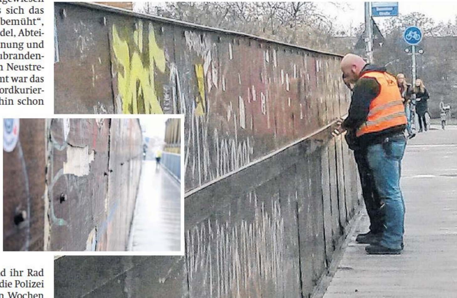
Gefahrenherd beseitigt: Die Schrauben, die an der Behelfsbrücke Demminer Straße aus der Befestigung herausragten, wurden mit einer Schutzplanke abgedeckt. FOTOS: RENÉ MARTIN/JÖRG FRANZE
